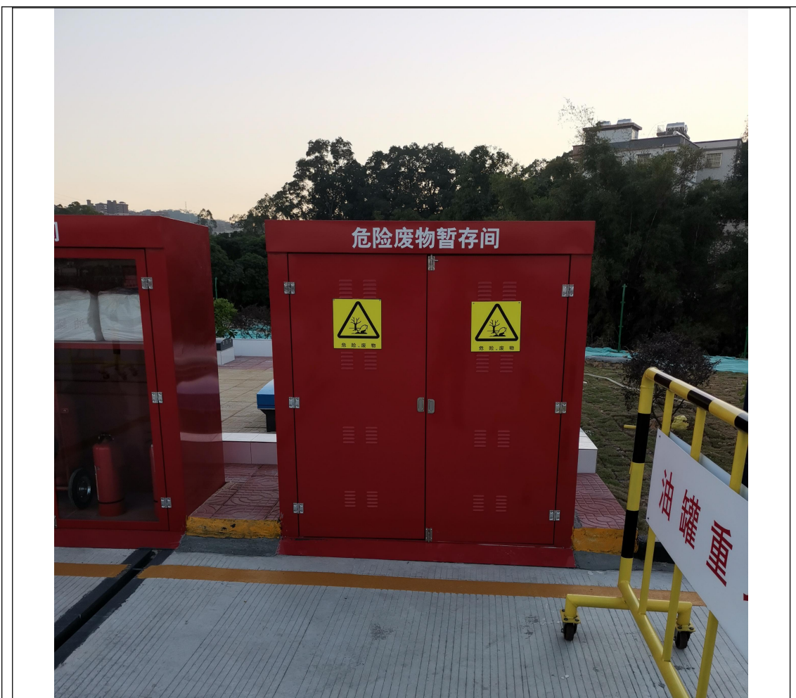
图 13 危废暂存间现场照片
