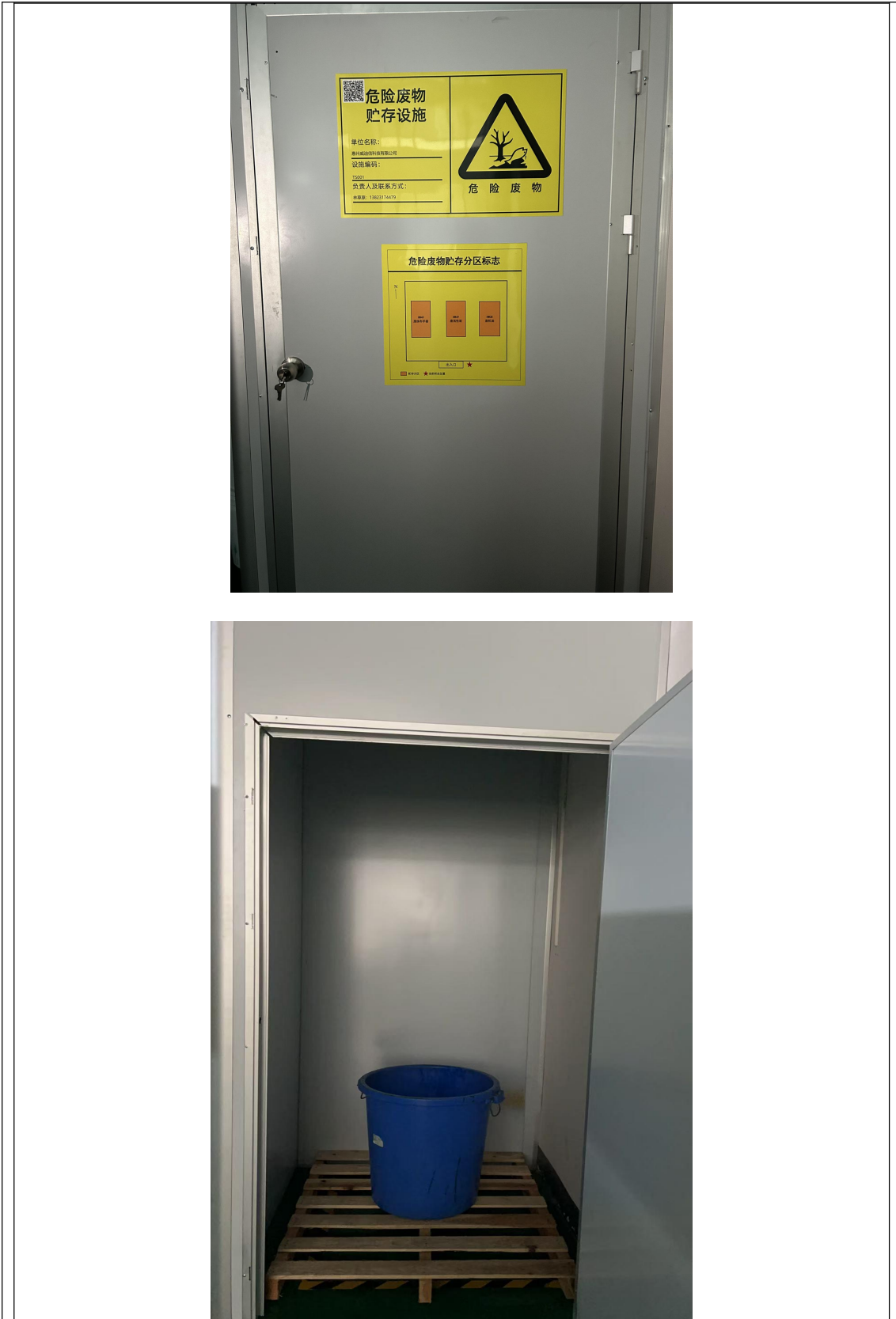
图 11 危废暂存间现场照片
