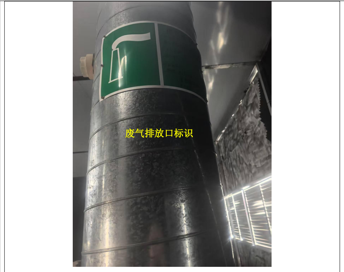
图 10 项目涂布烘干废气收集及废气处理设施现场照片
