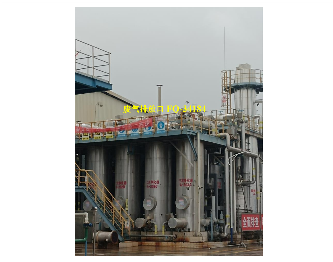
图4.1-3 项目废气处理设施现场照片
