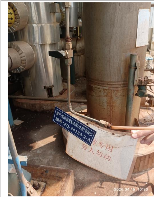
FQ-34184-2-A 脱烃装置后(减压后品控管)
