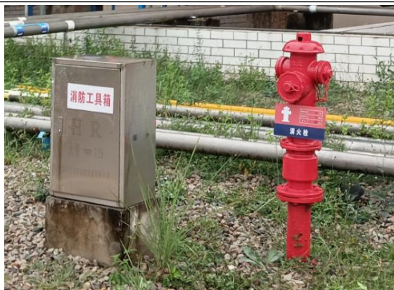
消防工具箱及消火栓
