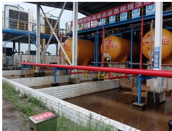
液氨储罐围堰
