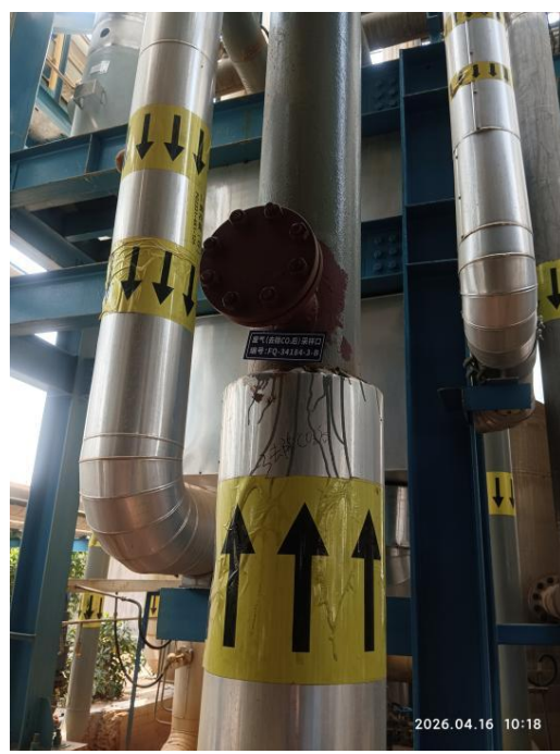
FQ-34184-3-B (不凝气排放口)
