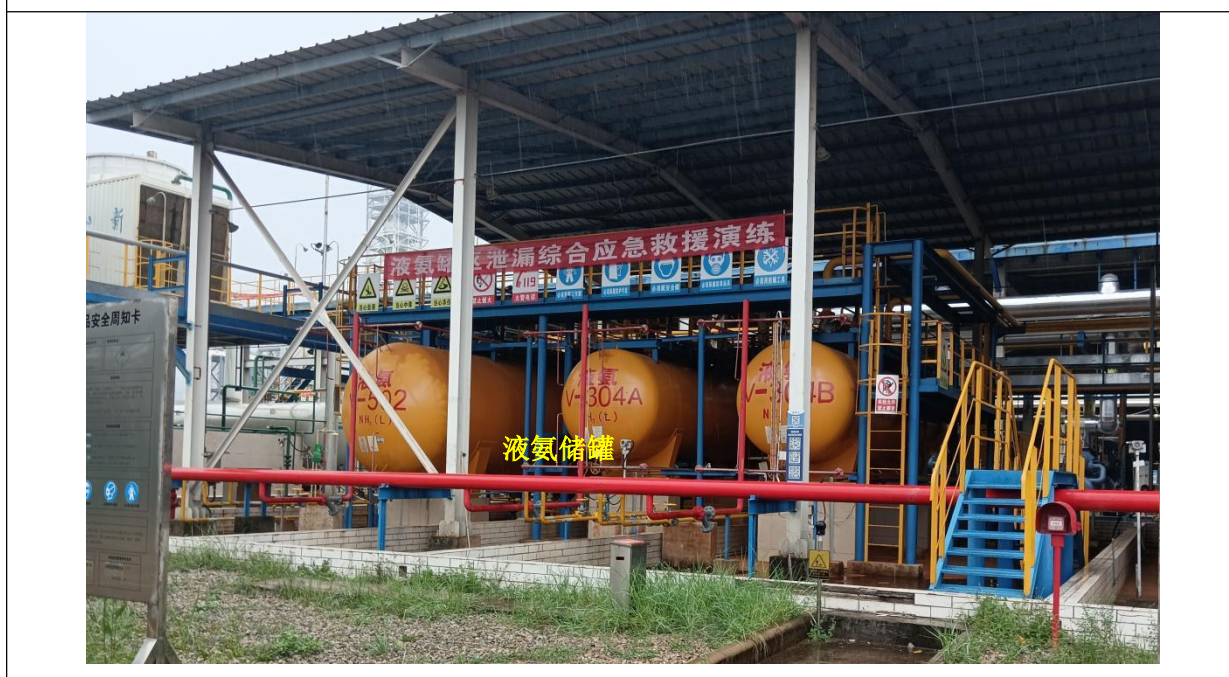
图 3.7-6 氨水生产装置现场照片
