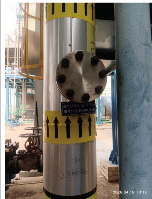
FQ-34184-2-B (不凝气排放口)
