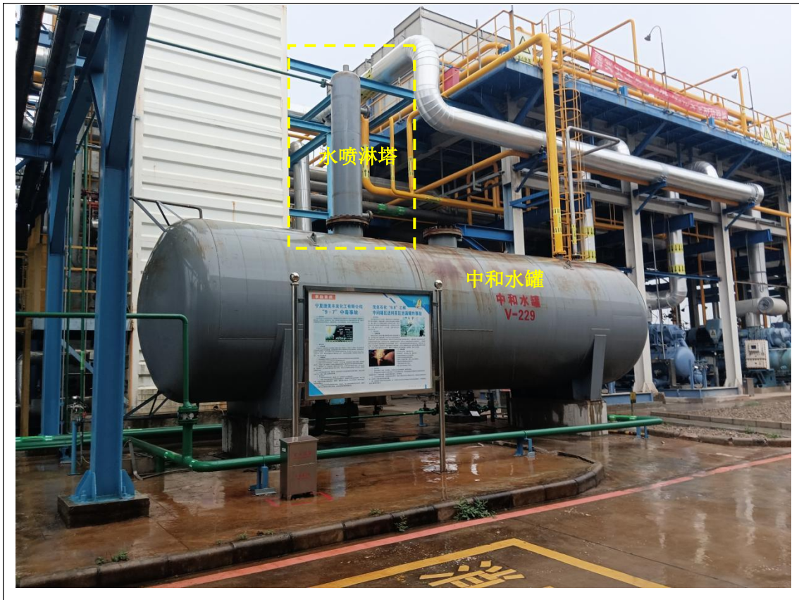
图4.1-5 项目氨水废气处理设施现场照片
