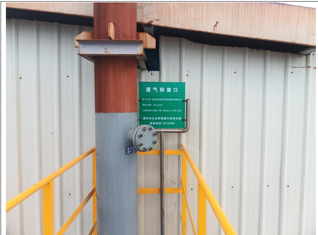
FQ-34184（汇总后总排口）
