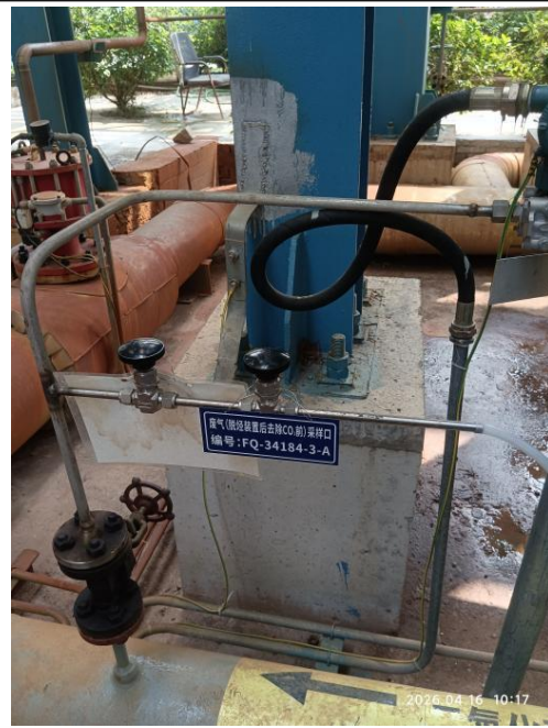
FQ-34184-3-A 脱烃装置后(减压后品控管)
