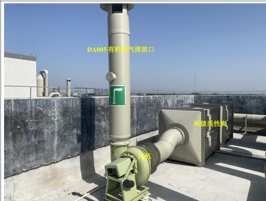
图 4.1-9 有机废气处理设施现场图
