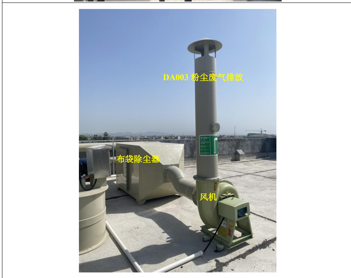
图 4.1-5 粉尘废气处理设施现场图
