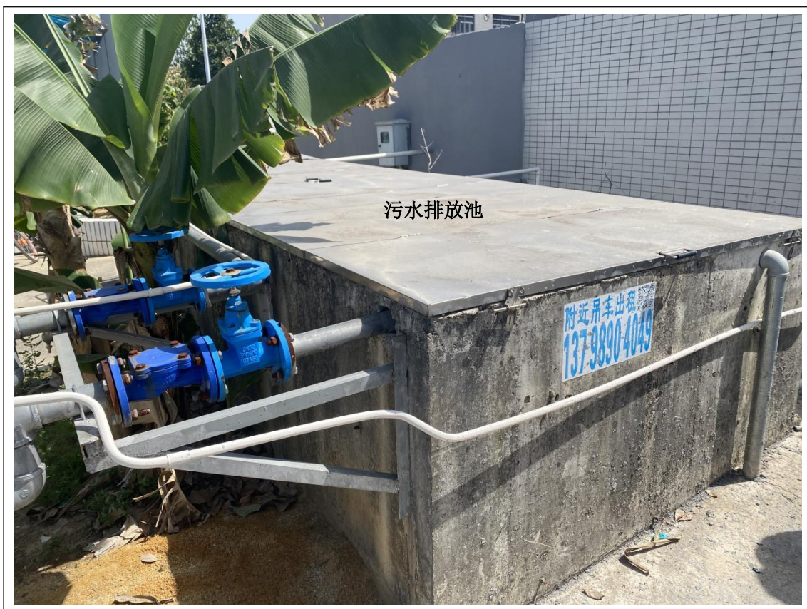
图 4.1-3 废水处理设施现场图
