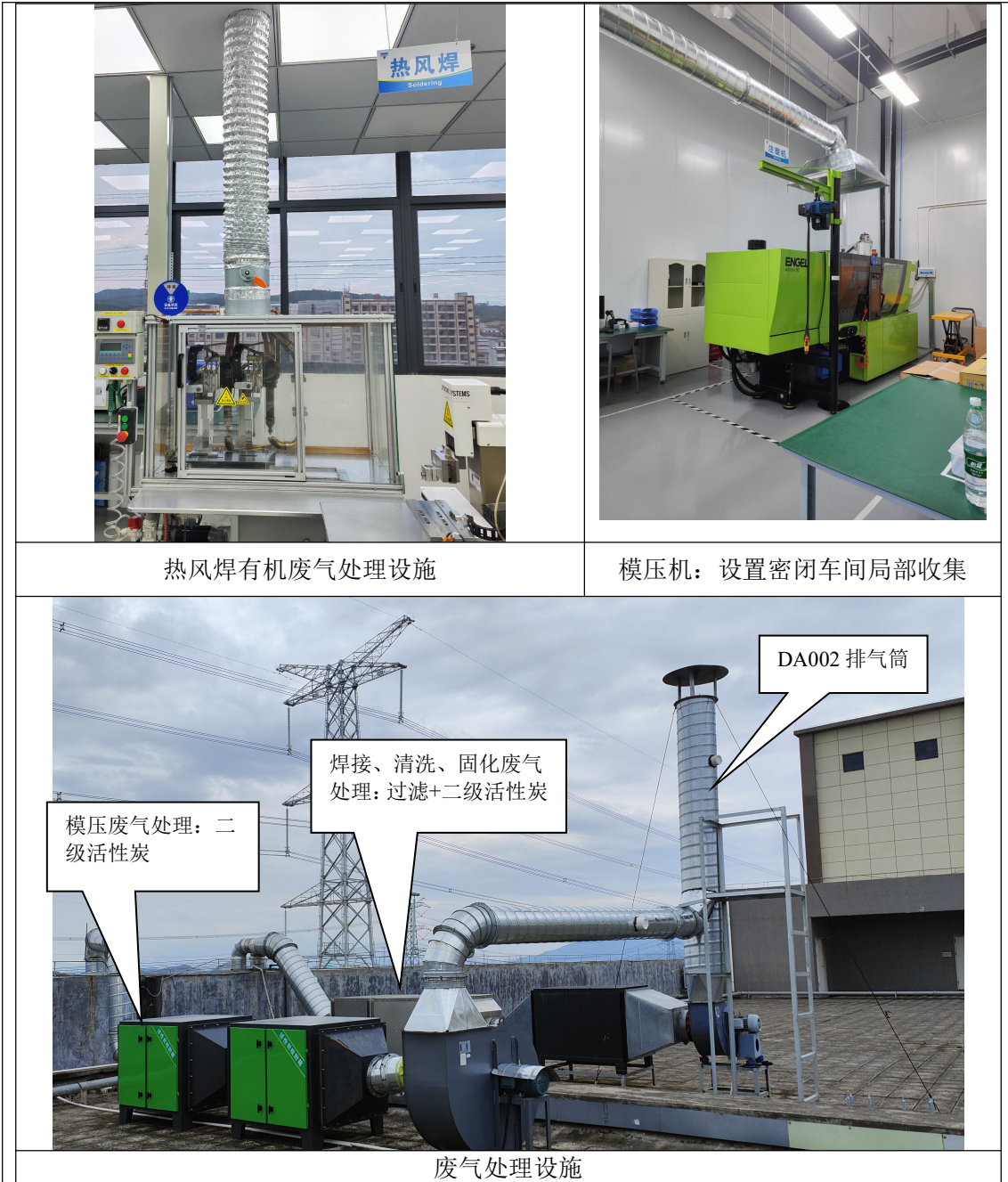
图 8 有机废气处理设施现场照片
