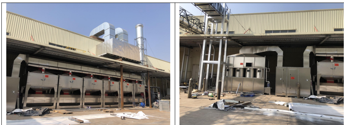
RCO 废气处理设施及 DA001 废气排放口
