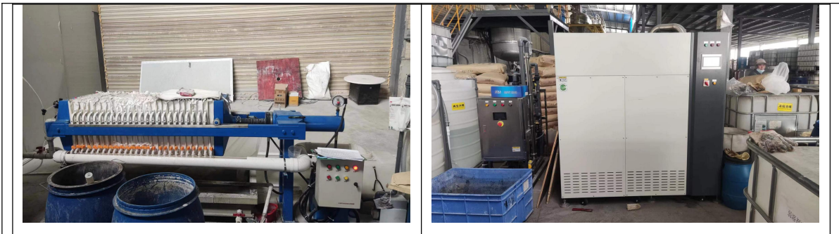
图 10 自建废水处理设施
