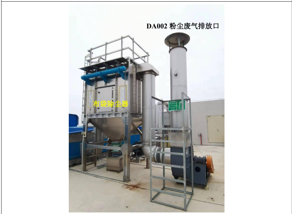
图 4.1-4 项目废气治理设施现场照片
