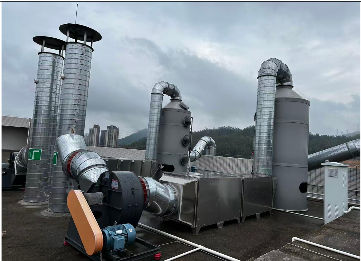
DA002废气处理设施（水喷淋+除雾器+两级活性炭）
