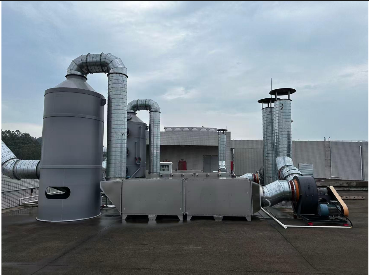
DA001废气处理设施（水喷淋+除雾器+两级活性炭）
