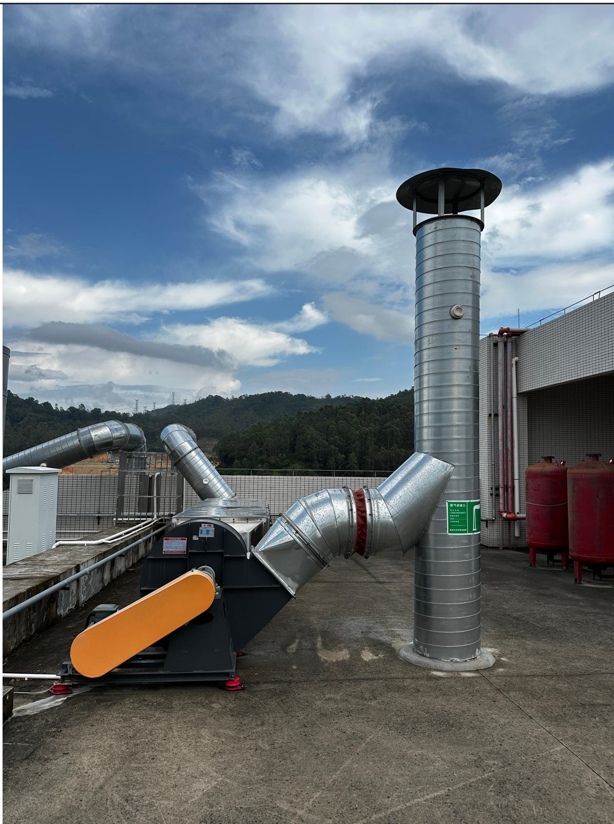
DA003废气处理设施（干式过滤器+两级活性炭）
