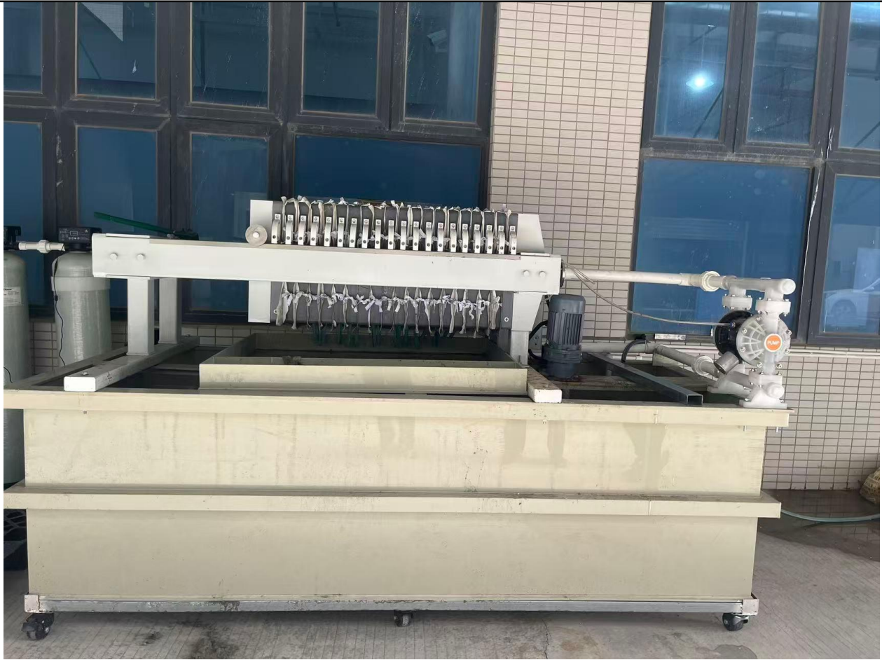
废水处理设施
