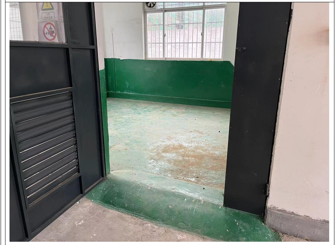
图 11 危废暂存间现场照片
