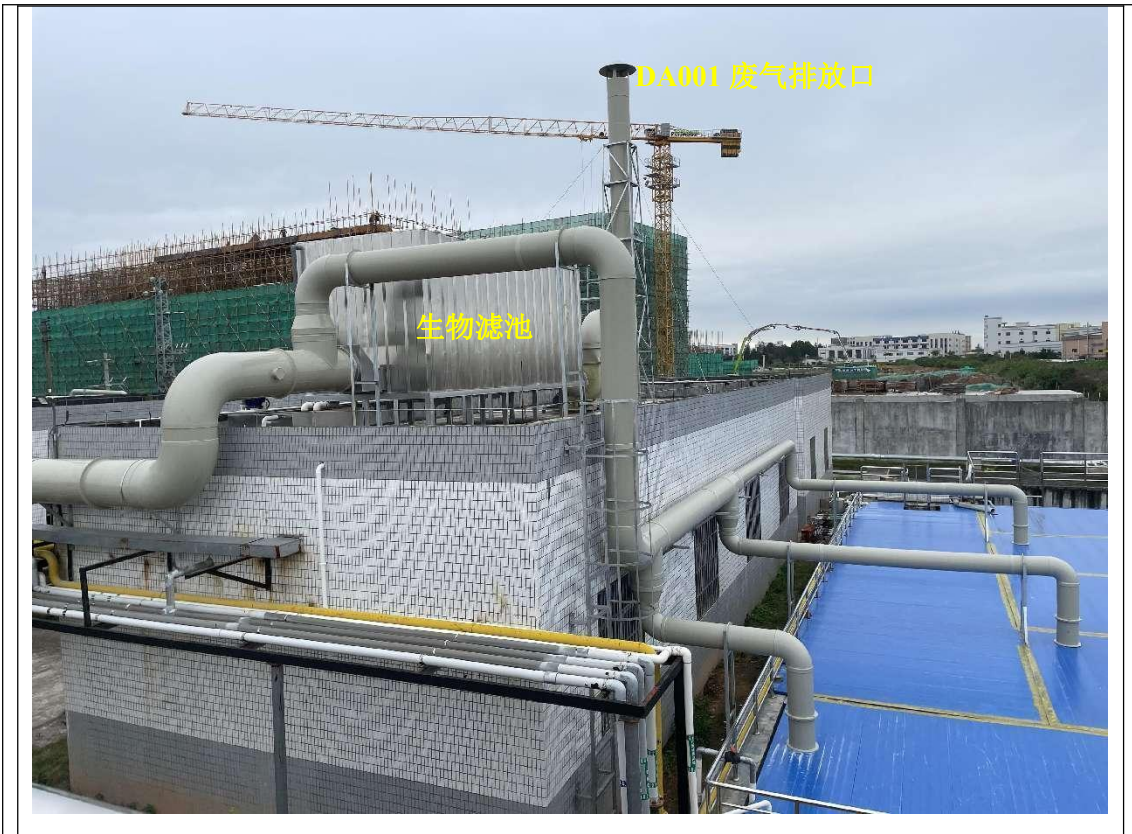
图9 废气防治设施现场照片
