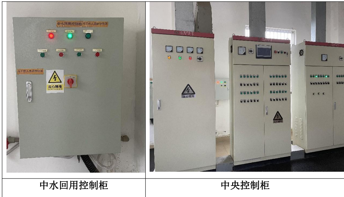
图 7 控制系统现场照片
