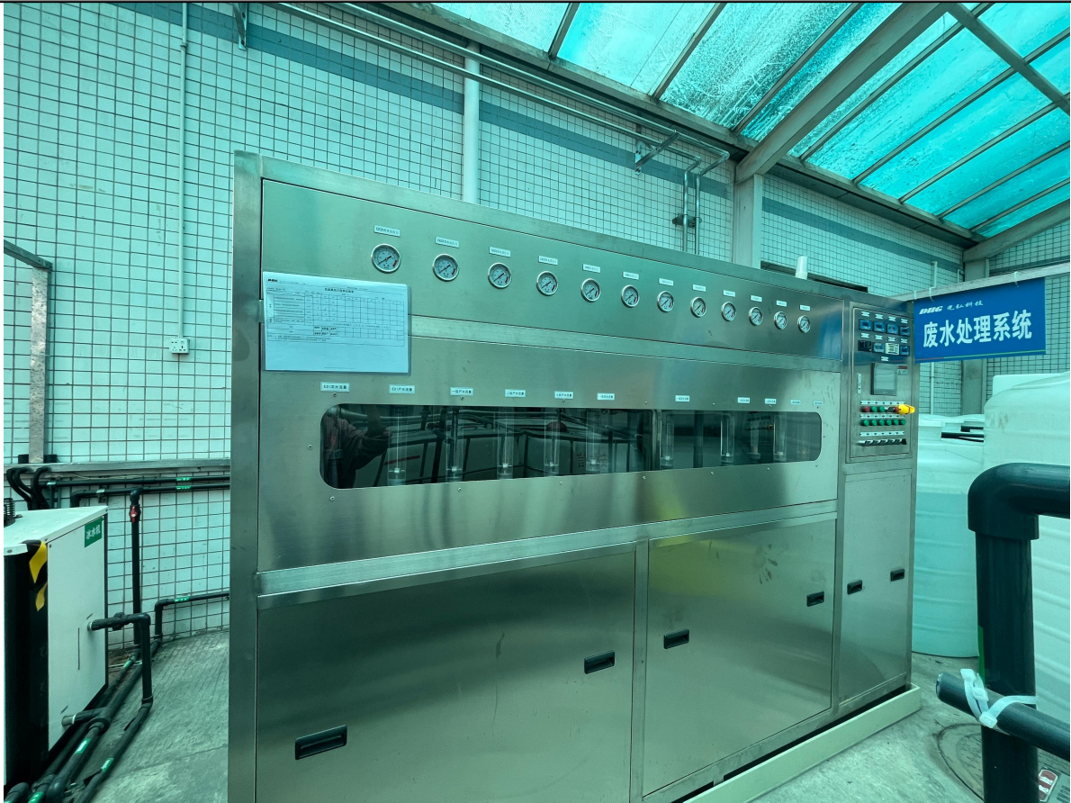
废水处理设施
