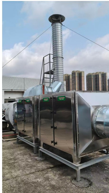
排气筒FQ-34437-9及废气处理设施
