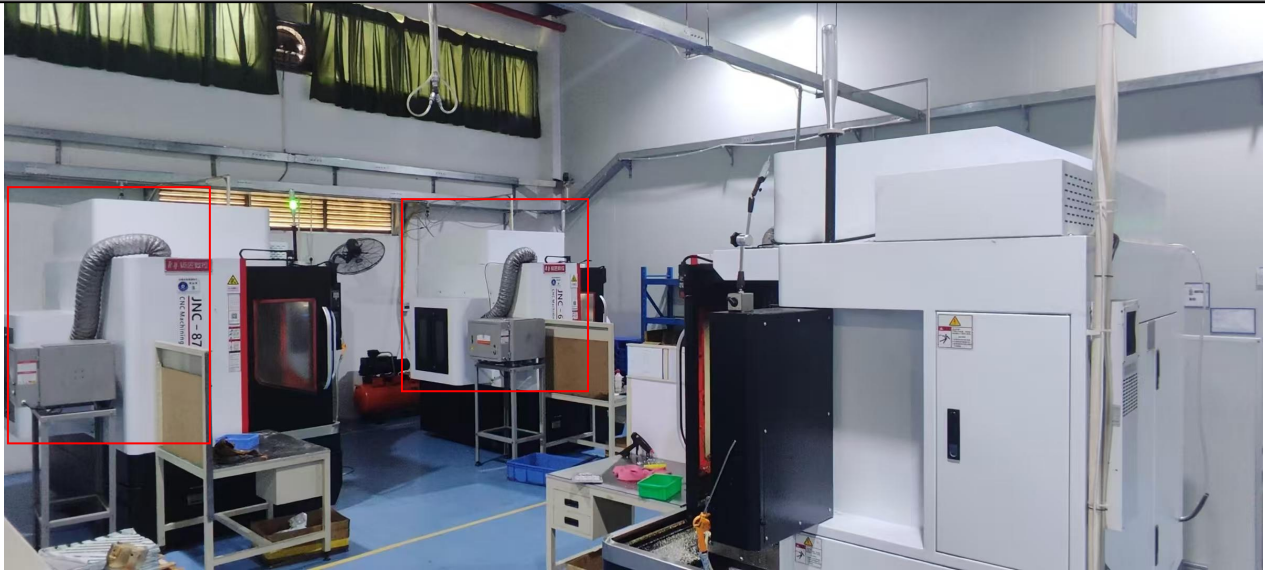
CNC设备自带废气处理设施
