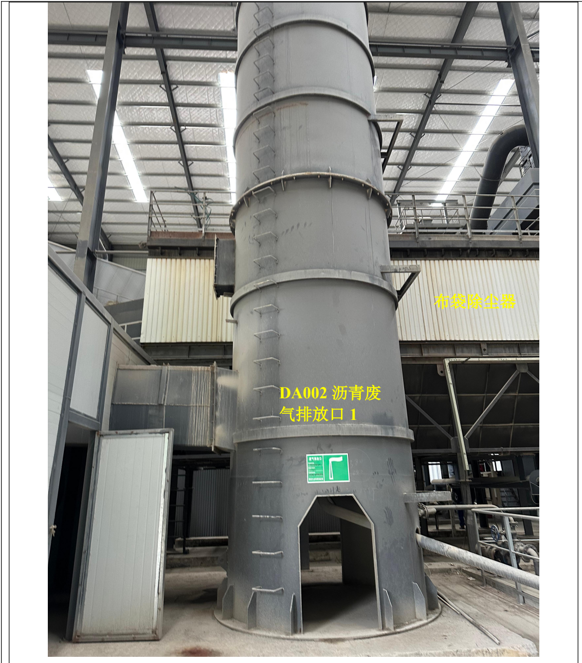
图 10 项目废气收集及污染防治措施现场照片
