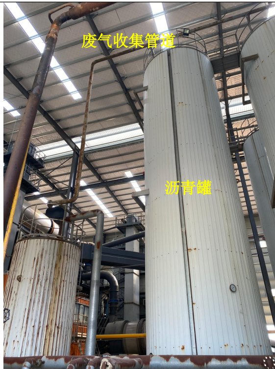
沥青储罐废气收集现场照片
