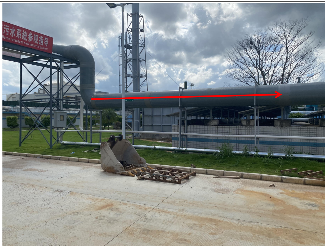
废气收集管道
