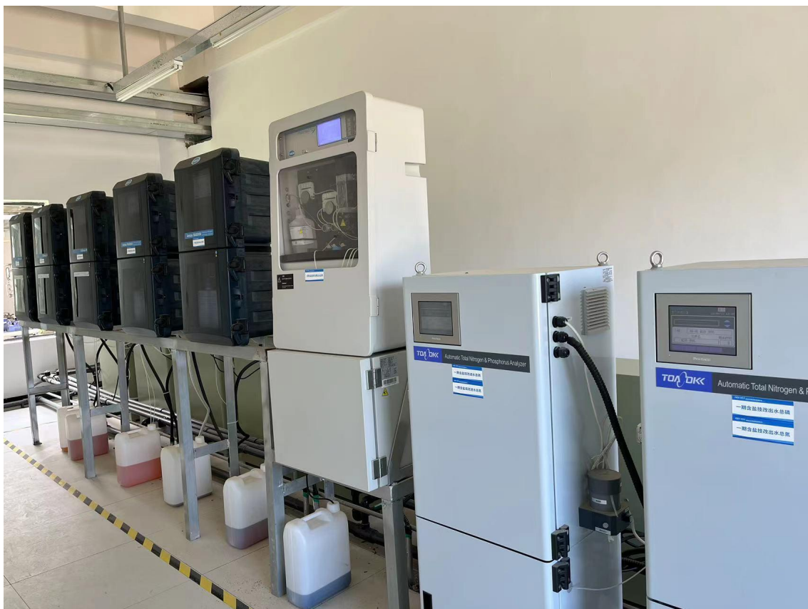
一期含盐高浓度（本技改项目）在线监控设施
