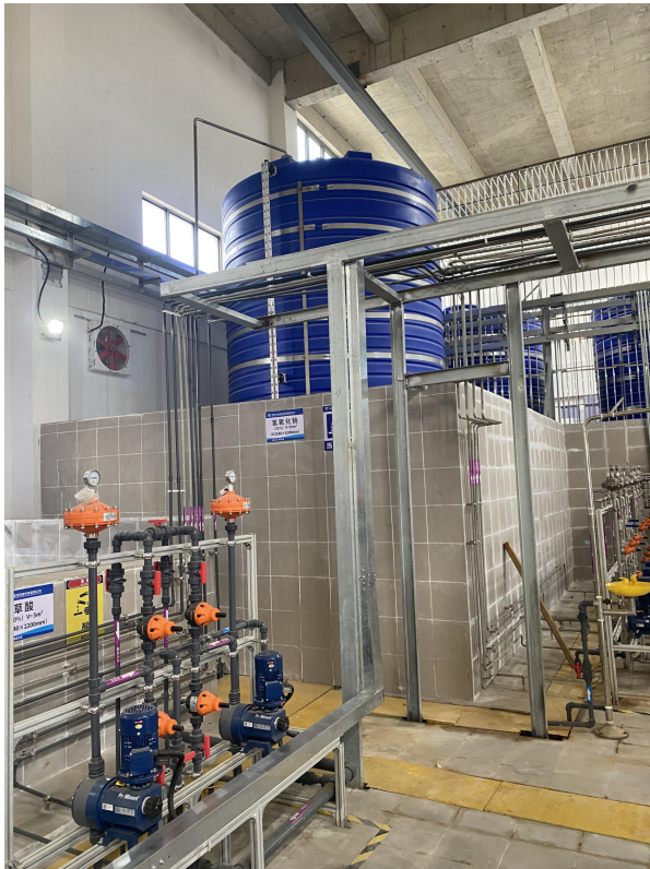
氢氧化钠储罐
