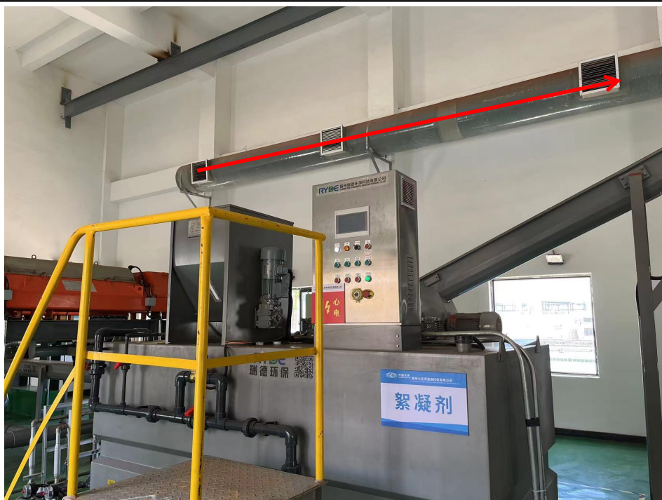
污泥干化间废气收集
