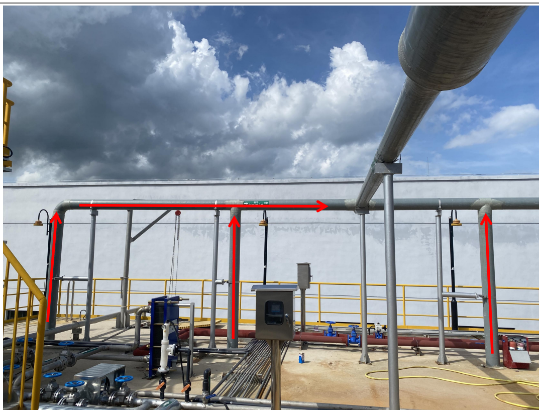
废气收集管道
