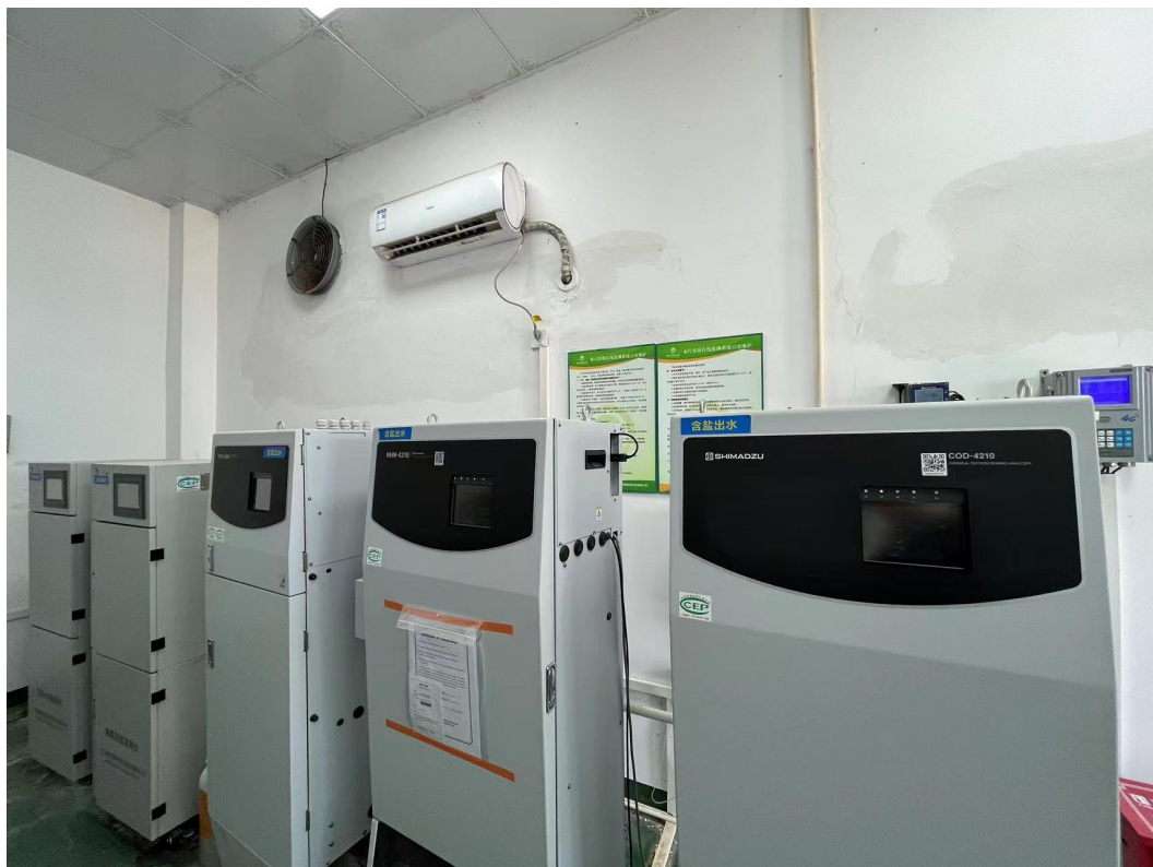
一期含盐出水在线监控设施
