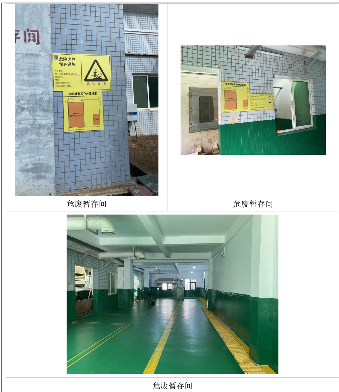
图 15 危险废物暂存间现场照片
