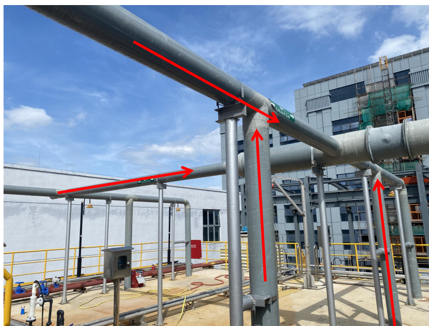
废气收集管道
