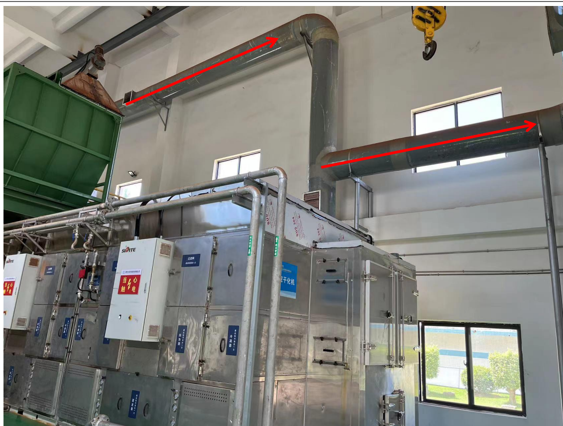
污泥干化间废气收集
