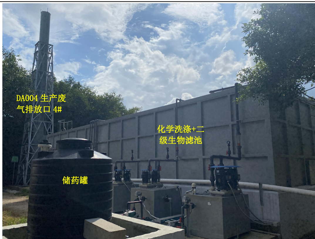
废气治理设施
