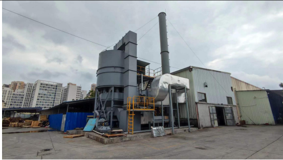
RTO 废气处理设施及 DA001 废气排放口
