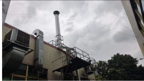
DA002 废气排放口
