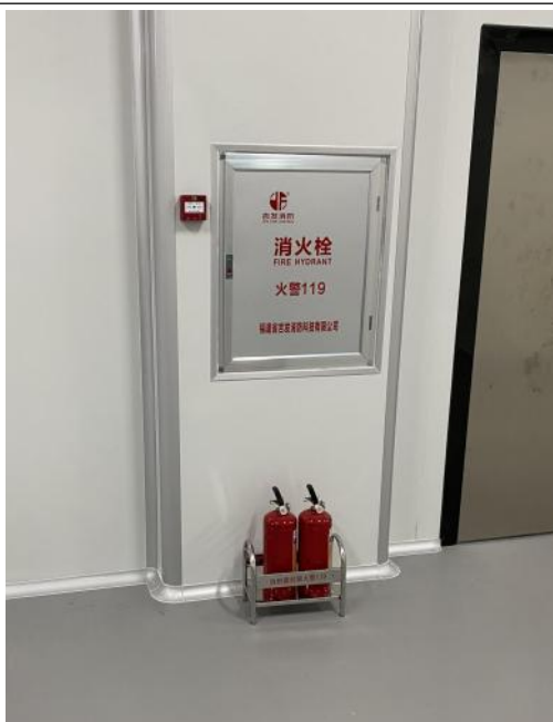
车间内消防栓及灭火器
