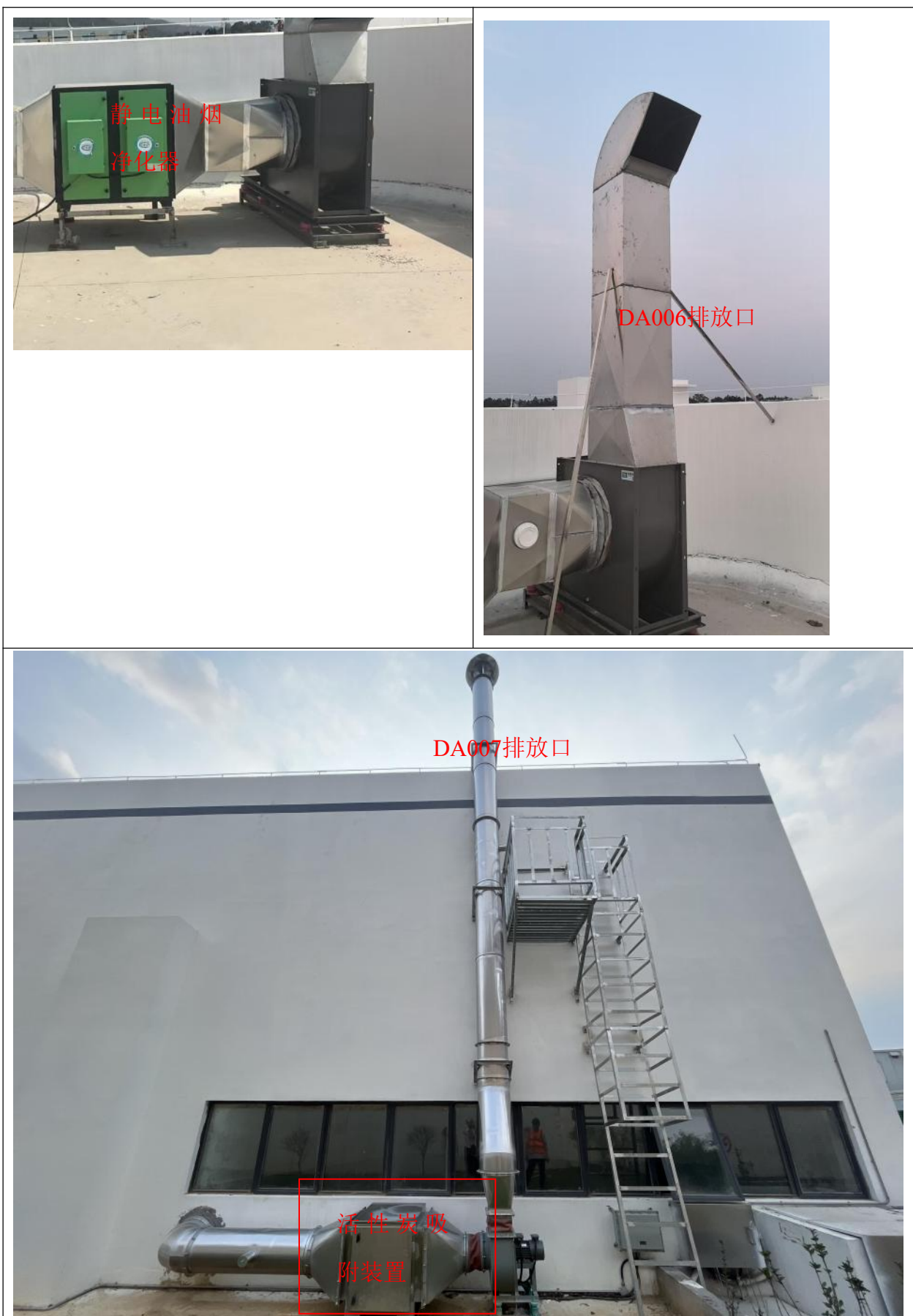
图 4.1-8 项目废气治理设施现场照片
