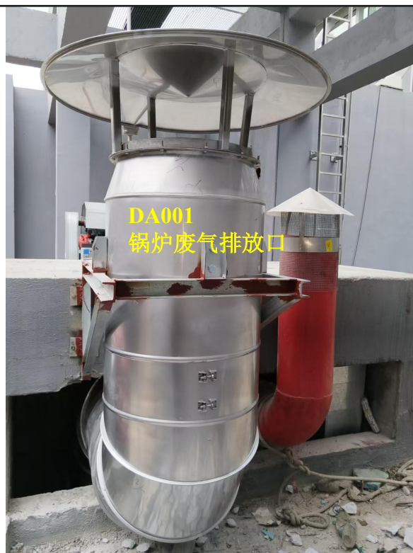
图 6 锅炉废气收集及废气排放口现场照片
