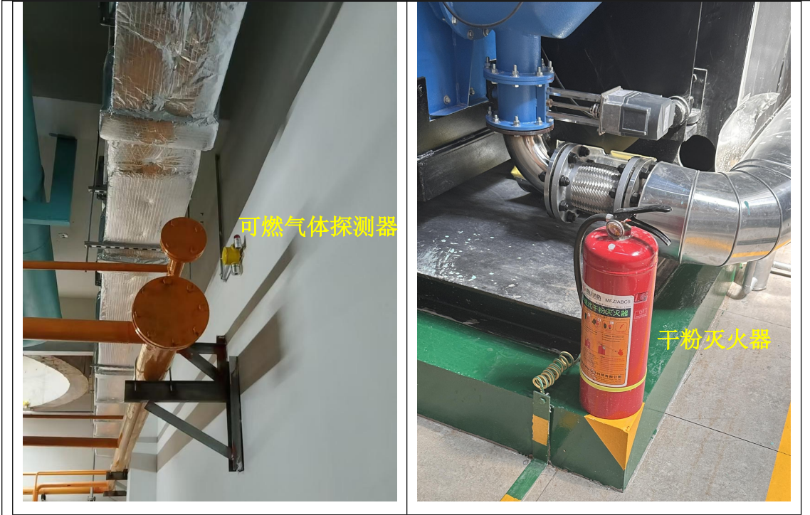
图 7 锅炉房配备应急物资
