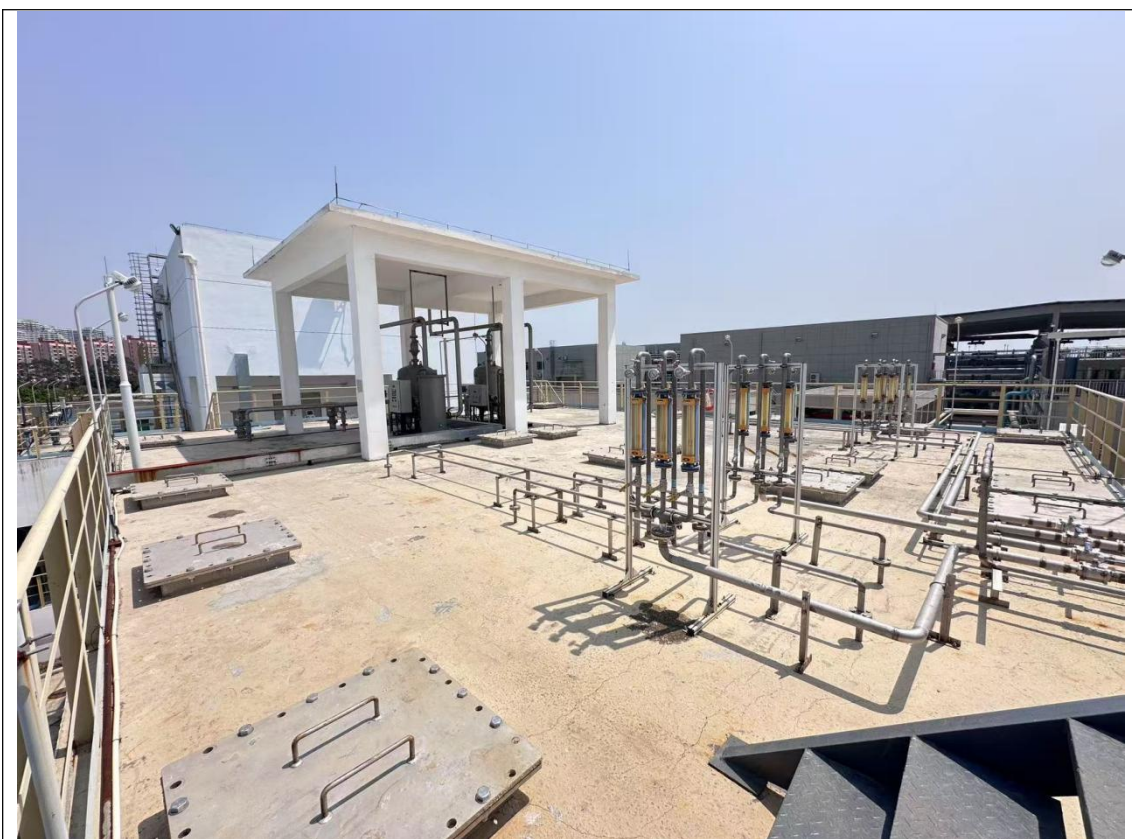
后臭氧氧化池
