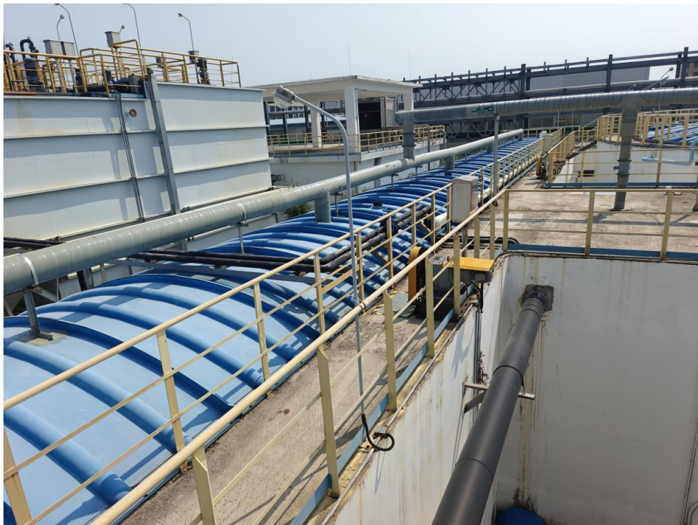
二沉池及储泥池
