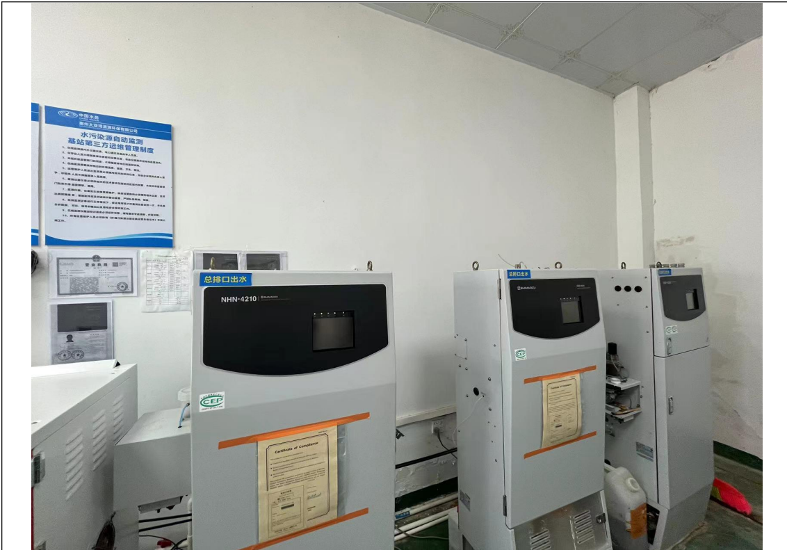
总排放口出水在线监控设施
