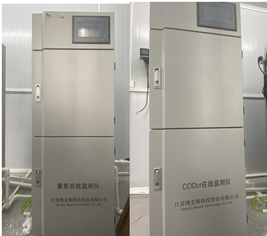
雨水排放口在线监控设施
