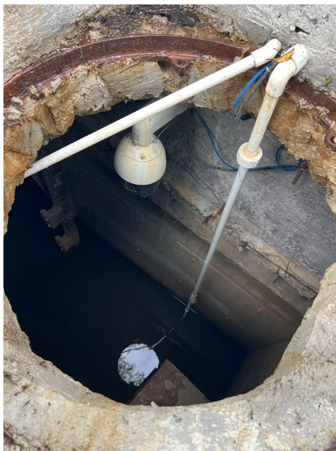
雨水排放口视频监控
