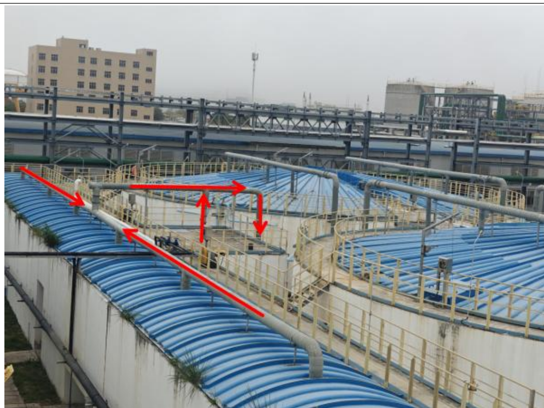
二沉池及储泥池废气收集
