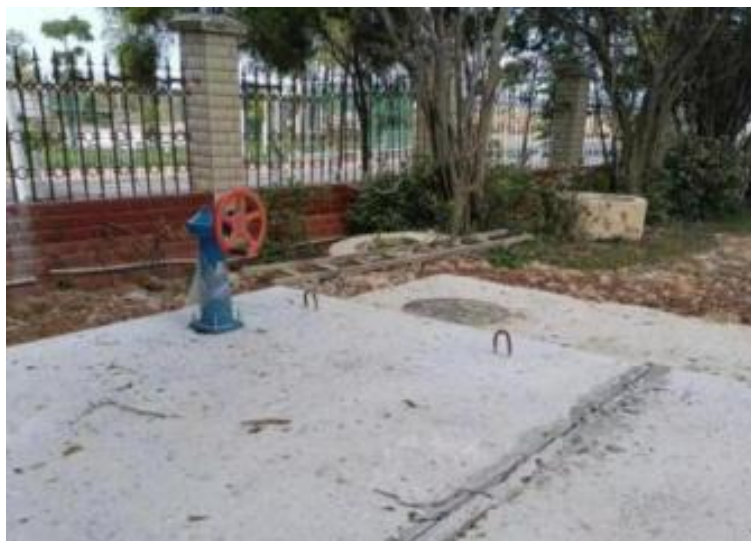
雨水排放口闸阀
