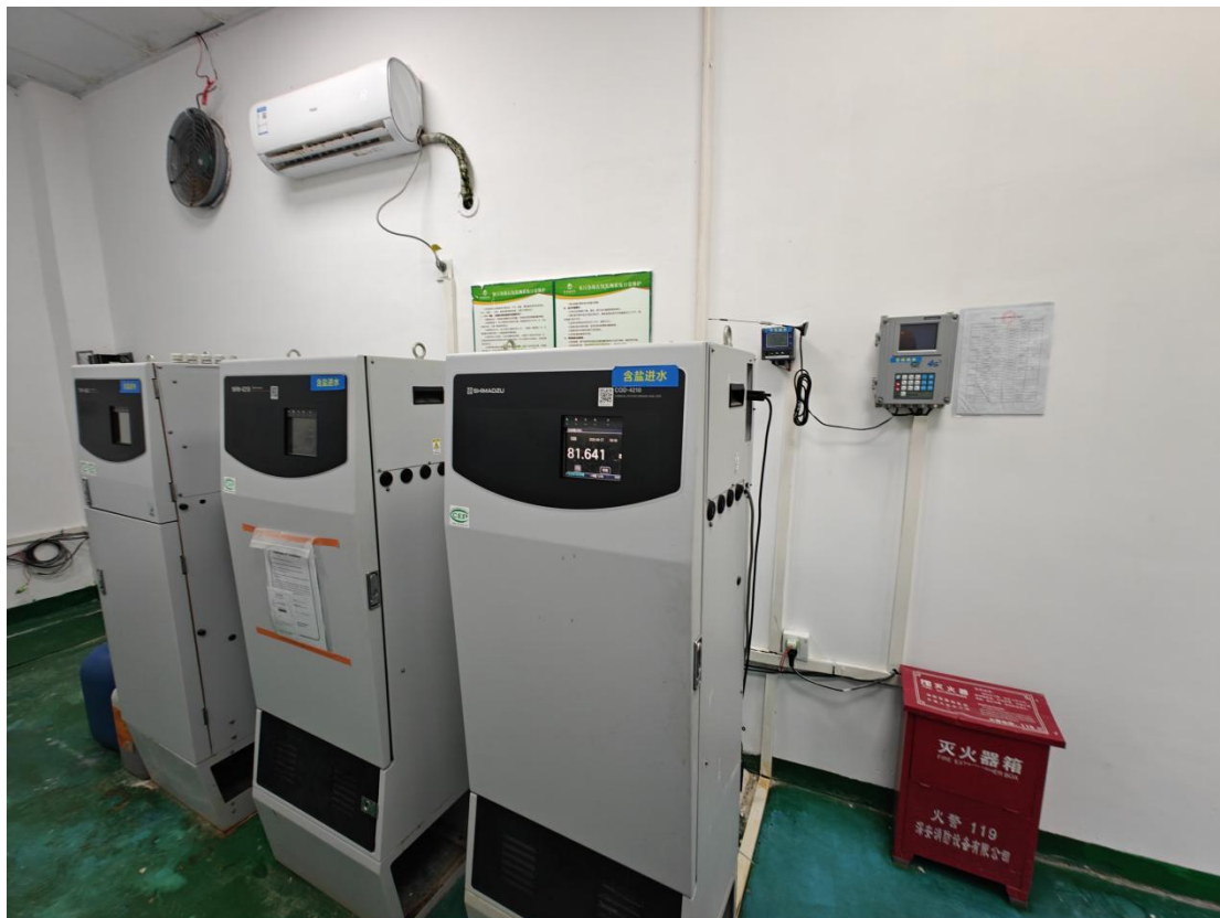
综合污水处理项目二期工程高化学需氧量含盐进水在线监控设施
