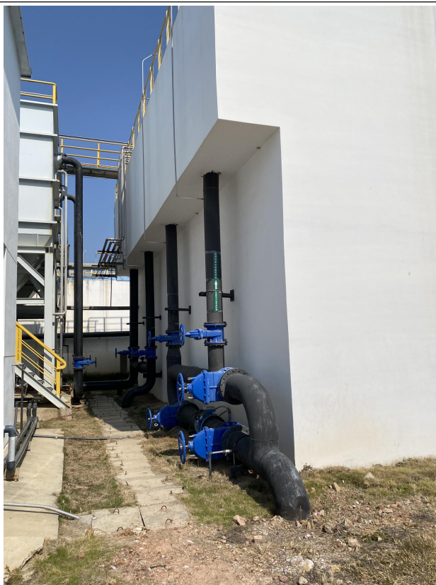
高化学需氧量含盐污水进水点
