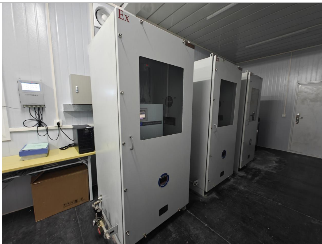
综合污水处理项目二期工程低化学需氧量含盐进水在线监控设施
