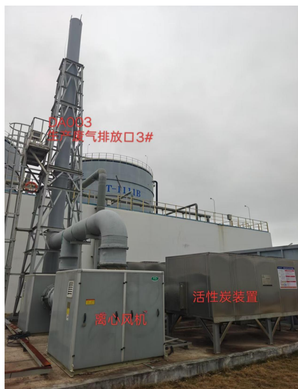
DA003 废气排放口
