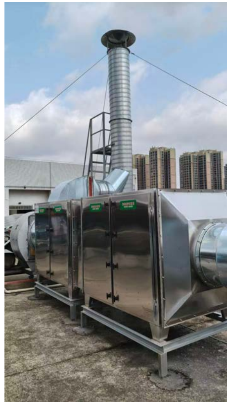
排气筒FQ-34437-9及废气处理设施
