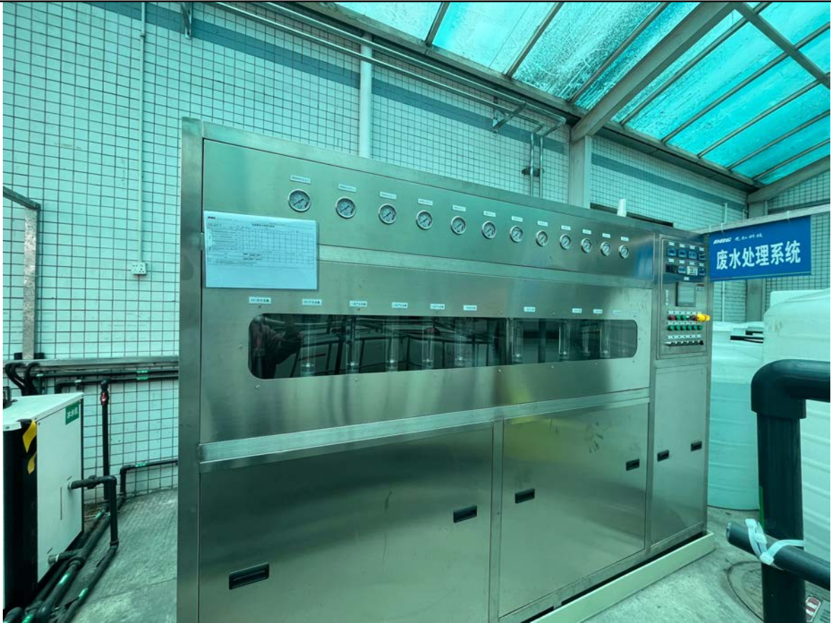
废水处理设施
