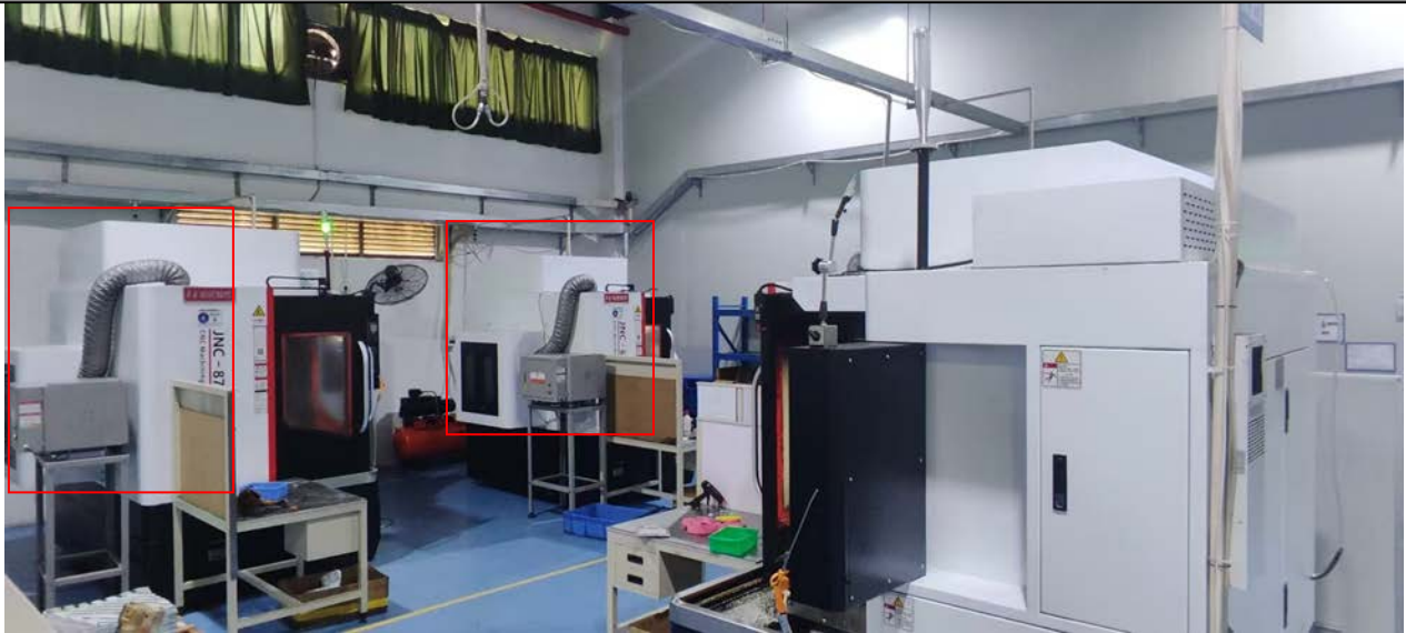
CNC设备自带废气处理设施
