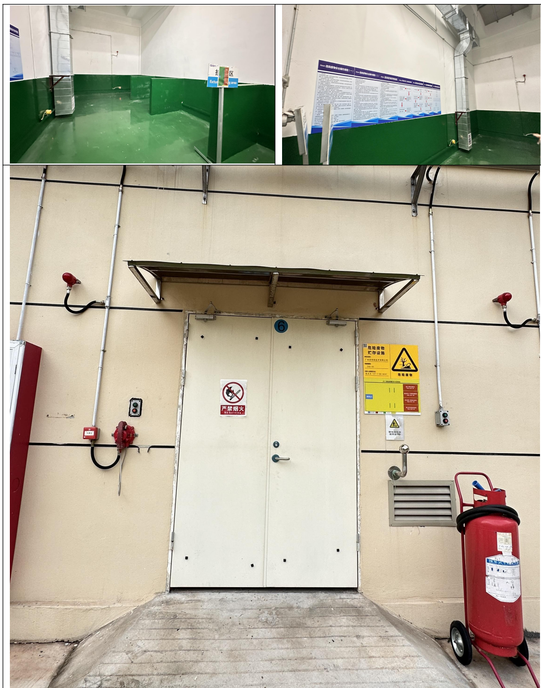
图 14 危废间现场照片
