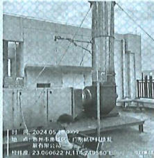
图 25: DA001 废气处理后采 样口 (2024.05.18 第 1 次)
