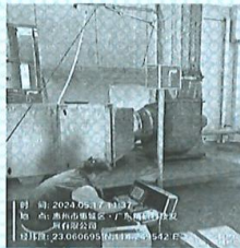
图 6: DA001 废气处理后采样口 (2024.05.17 第 3 次)
