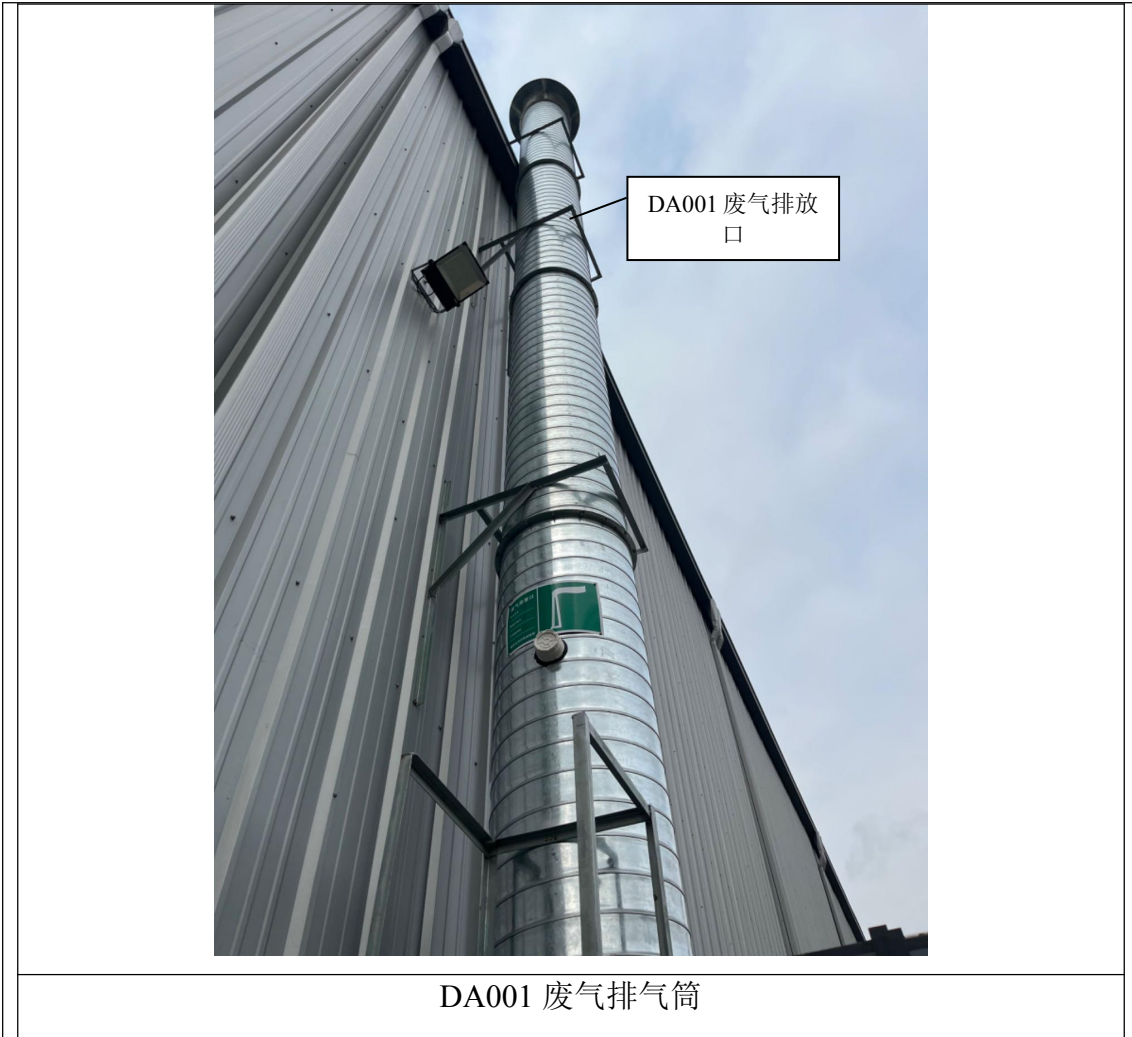
图 7 有机废气处理设施现场照片
