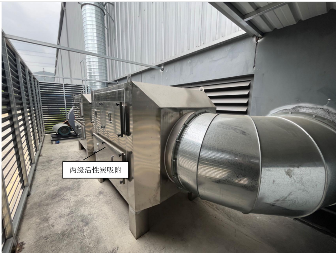
有机废气处理设施
