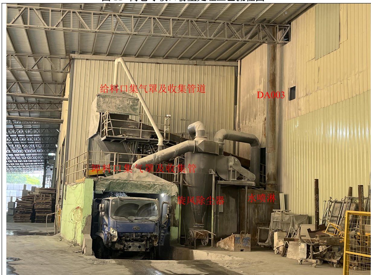
底皮破碎废气收集管道、旋风回收+水喷淋塔及 DA003 排放口
