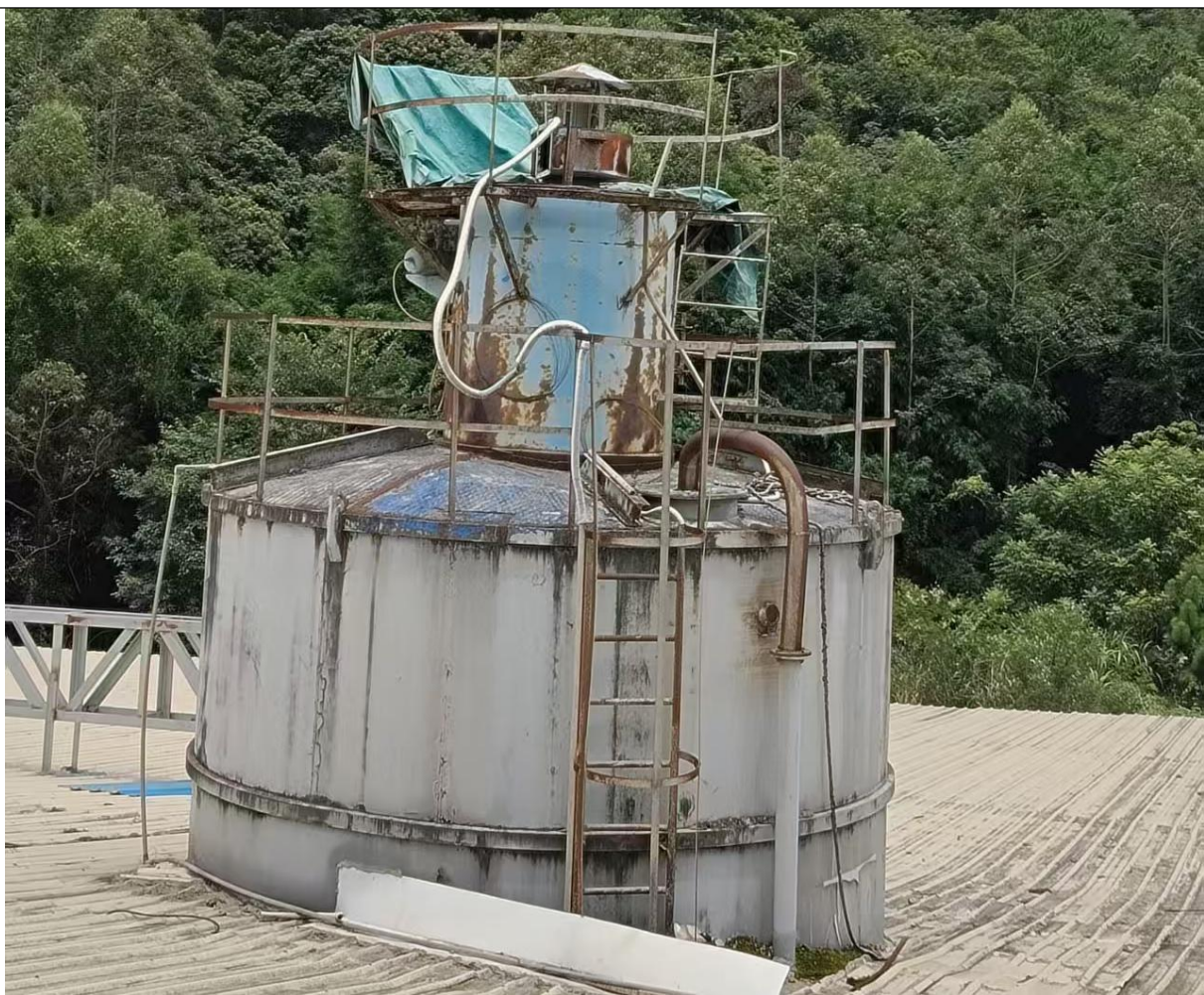
筒仓布袋除尘器
