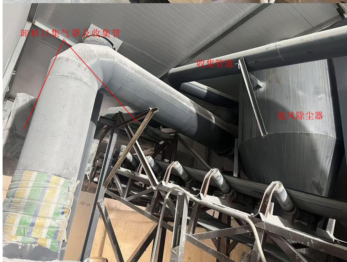
废料破碎废气收集管道及旋风回收+布袋除尘器
