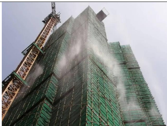
塔吊喷淋系统
