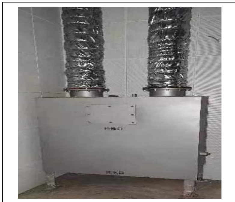
图 4.2- 1 废气处理措施现场图
