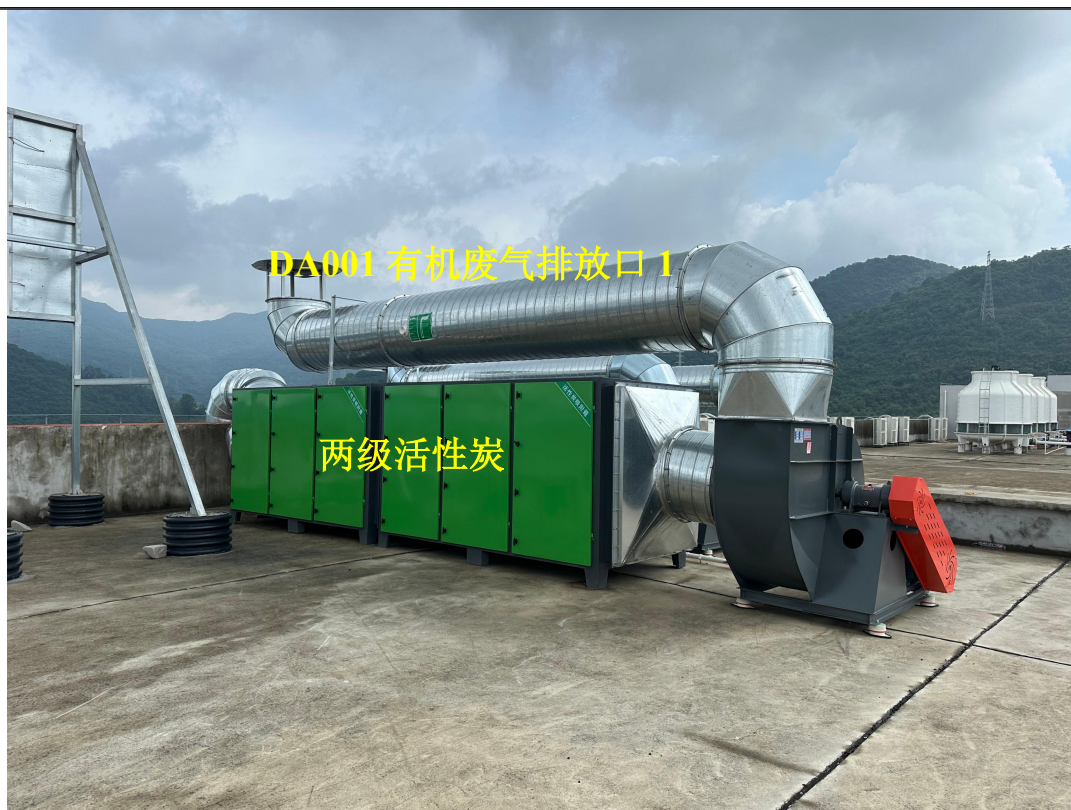
DA001 有机废气排放口 1
