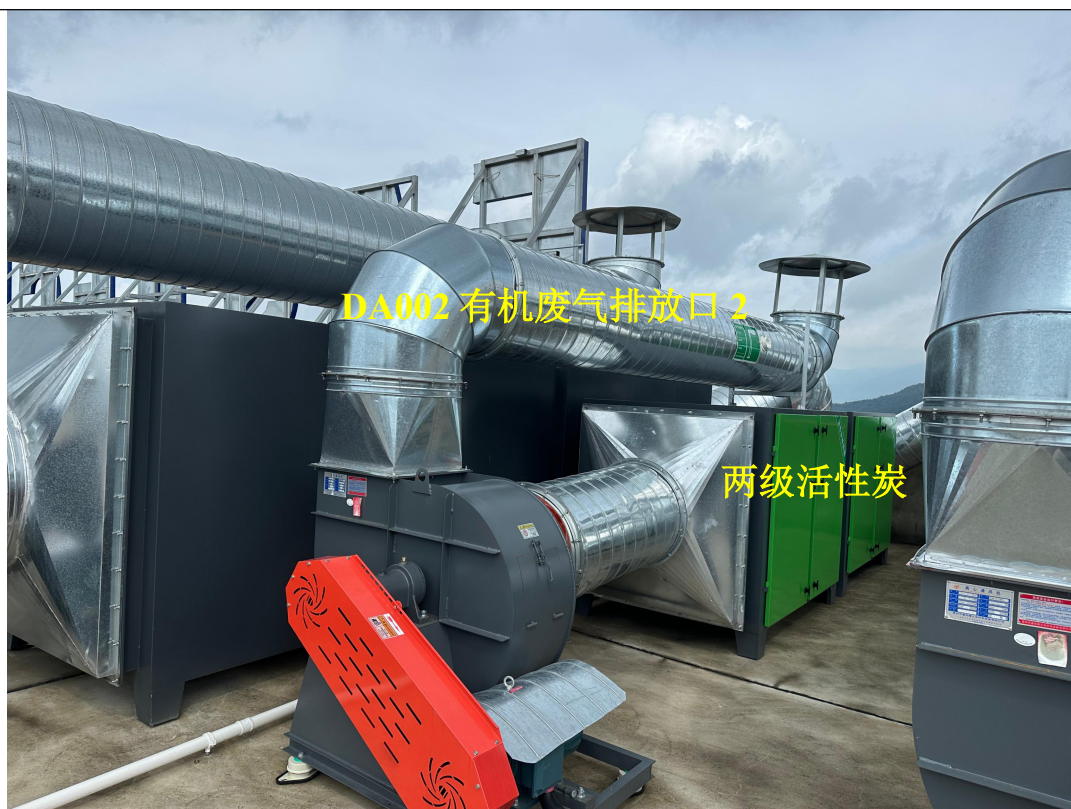
DA002 有机废气排放口 2
